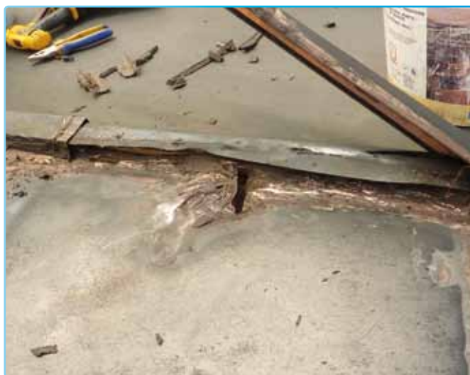
Una veduta dei danni del tetto
